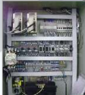
電器箱 Electrical Cabinet
